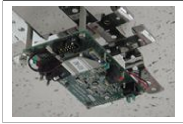
図 3 天井に設置した改良前のセンサノード
