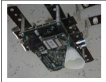
図 4 天井に設置した改良後のセンサノード
