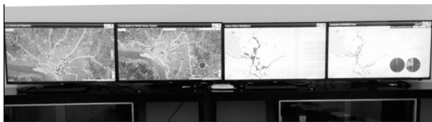
図 4 モニタリングシステム
